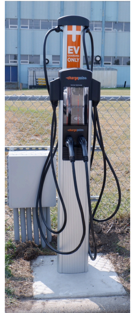
Une borne de recharge ChargePoint de niveau 2 a été installée au lycée Crescent Heights.
