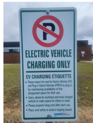
Signalétique de la borne de recharge installée au lycée de The Woodlands.
